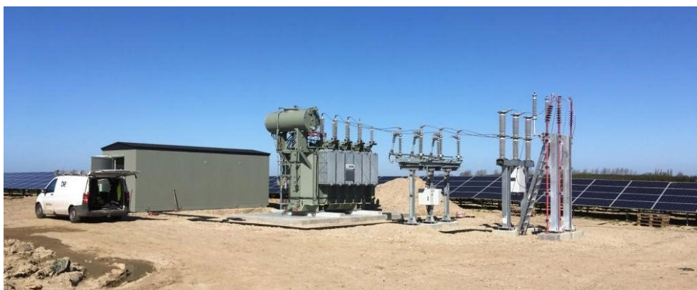
Figur 1-6 Eksempel på stepup-transformer og teknikbygning.
